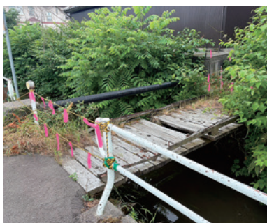
長久橋から蜘蛛橋間に存在する壊れて危険な木造橋
