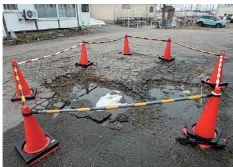
駅前交番脇は、路面が大きく深くへこんだ状態が長期間そのままとなっている
