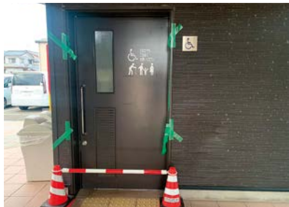
深く押しつぶされている条南あおば公園の多目的トイレの壁面
