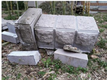
倒壊した自然石の塀
