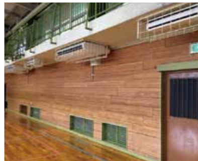
体育館に設置された空調設備
