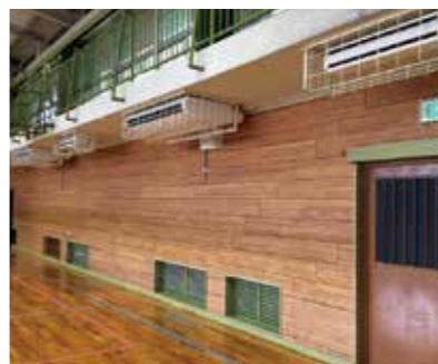
体育館に設置された空調設備
