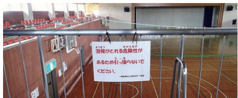
危険な下田体育館2階ギャラリーの手すり
