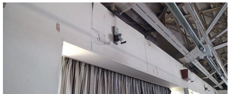
穴だらけな下田体育館2階ギャラリーの壁
