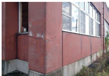
老朽化した下田体育館の壁
