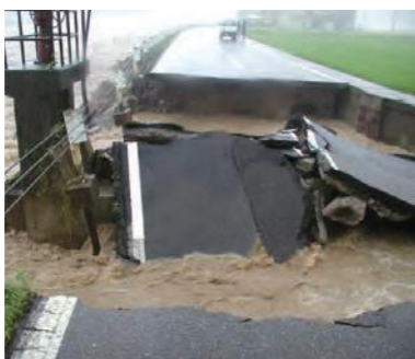
平成16年 7.13水害 国道289号(荒沢地内)破堤する被害
