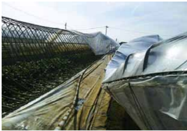
倒壊した農業用ハウス
