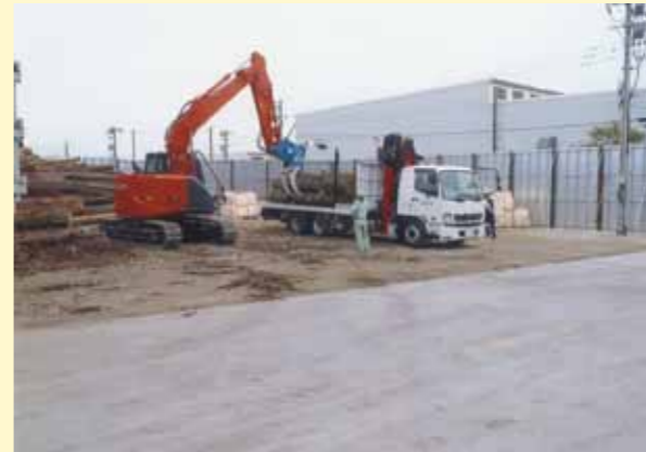
バイオマス発電所の燃料
