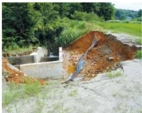
上谷地地内の災害現場
