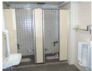
改善が必要な箇所
