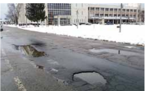
道路の破損(下田中学校前)
