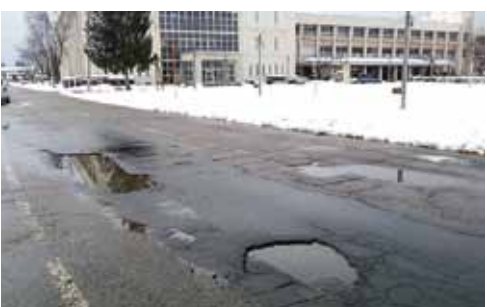
道路の破損(下田中学校前)
