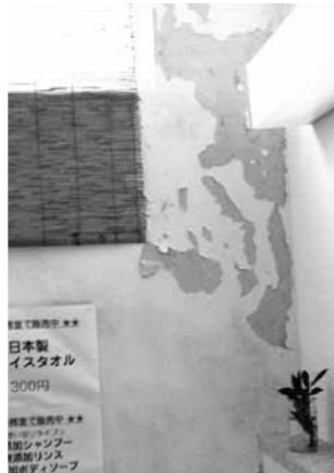
ポロポロになった浴室の壁
