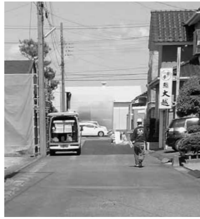
補修を待つ道路
