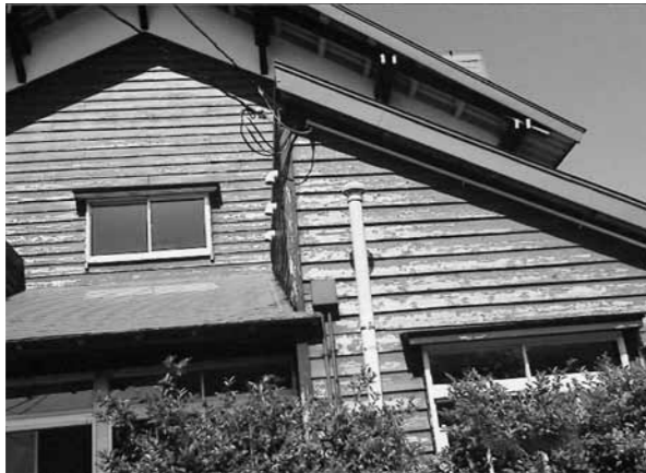
塗装がはげたままの外壁
