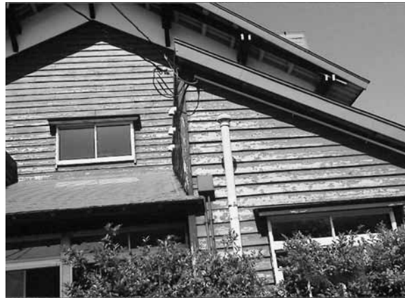
塗装がはげたままの外壁
