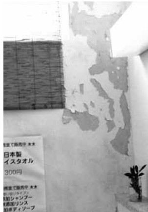
ボロボロになった浴室の壁
