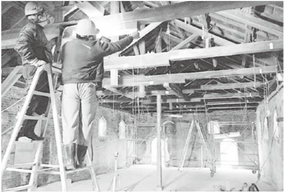
3月中旬のオープンに向け工事中の中心市街地拠点施設
