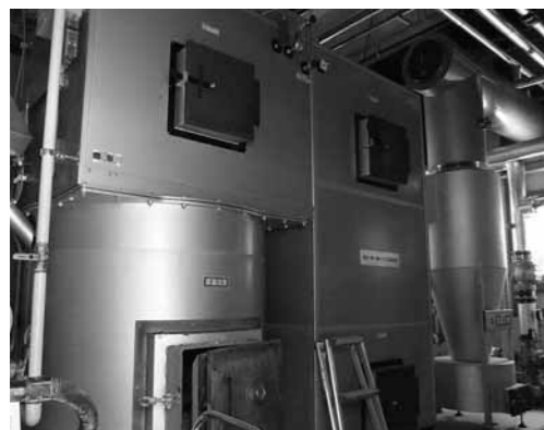
被災した「いい湯らてい」のペレットボイラー
