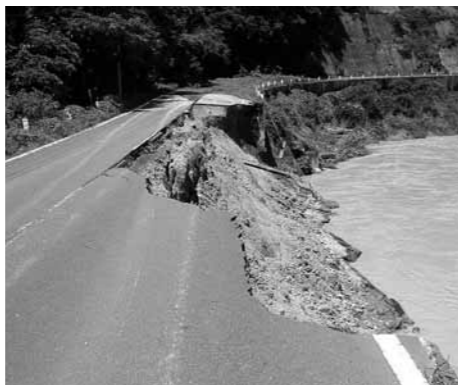
7・29豪雨災害で崩壊した市道 道心坂付近
