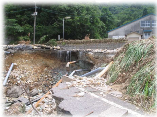
被害を受けた笠堀浄水場
