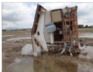
堤防決壊による家屋の倒壊
