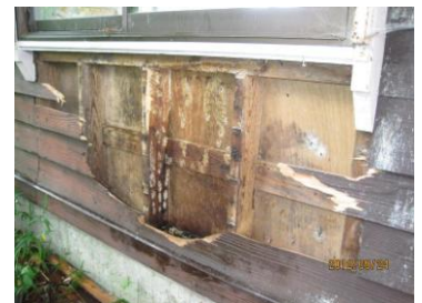
クマに壊された壁
