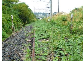
JR常磐線 消えていく線路
