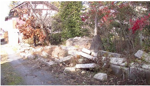
作業前・崩れた石垣
