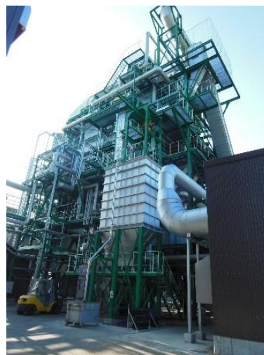
▲木質バイオマス 三条保内発電所
