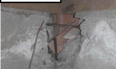
基礎内部鉄筋の露出
