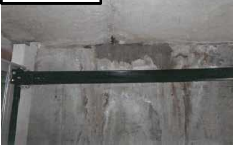
基礎内部さび汁
