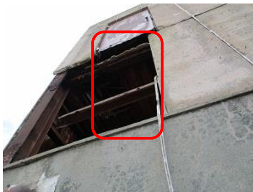
4月18日被害後の状況
