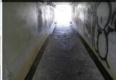
② 薄暗く落書きが多い地下通路
