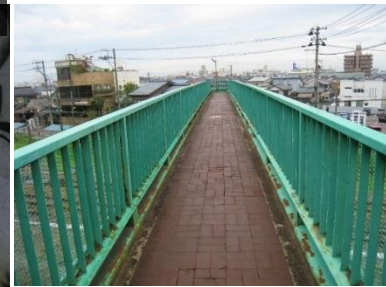
③ 老朽化した高架歩道橋
