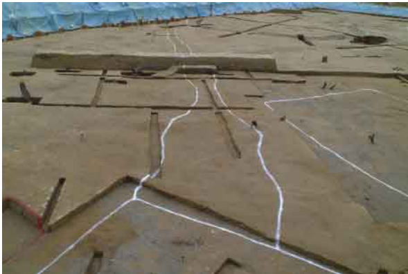
北側から見た地割れの様子
